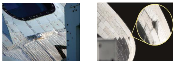
图26 航天飞机隔热毡损伤照片
